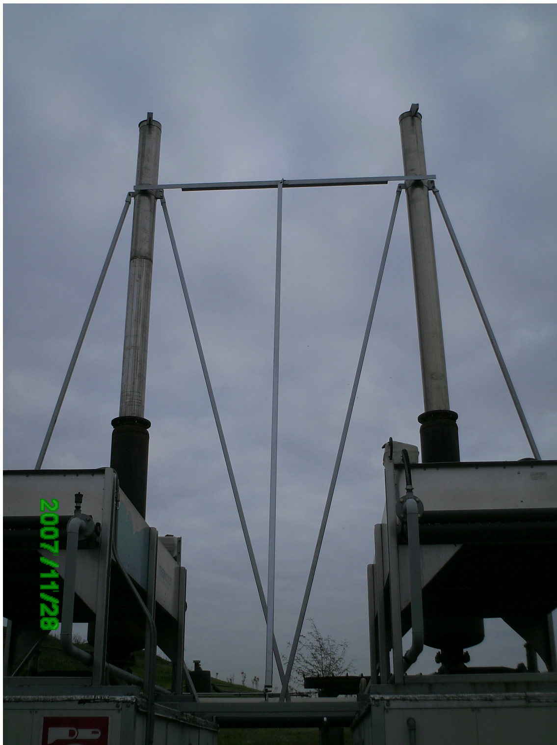
Foto1 camini dei motogeneratori innalzati a 10 metri
