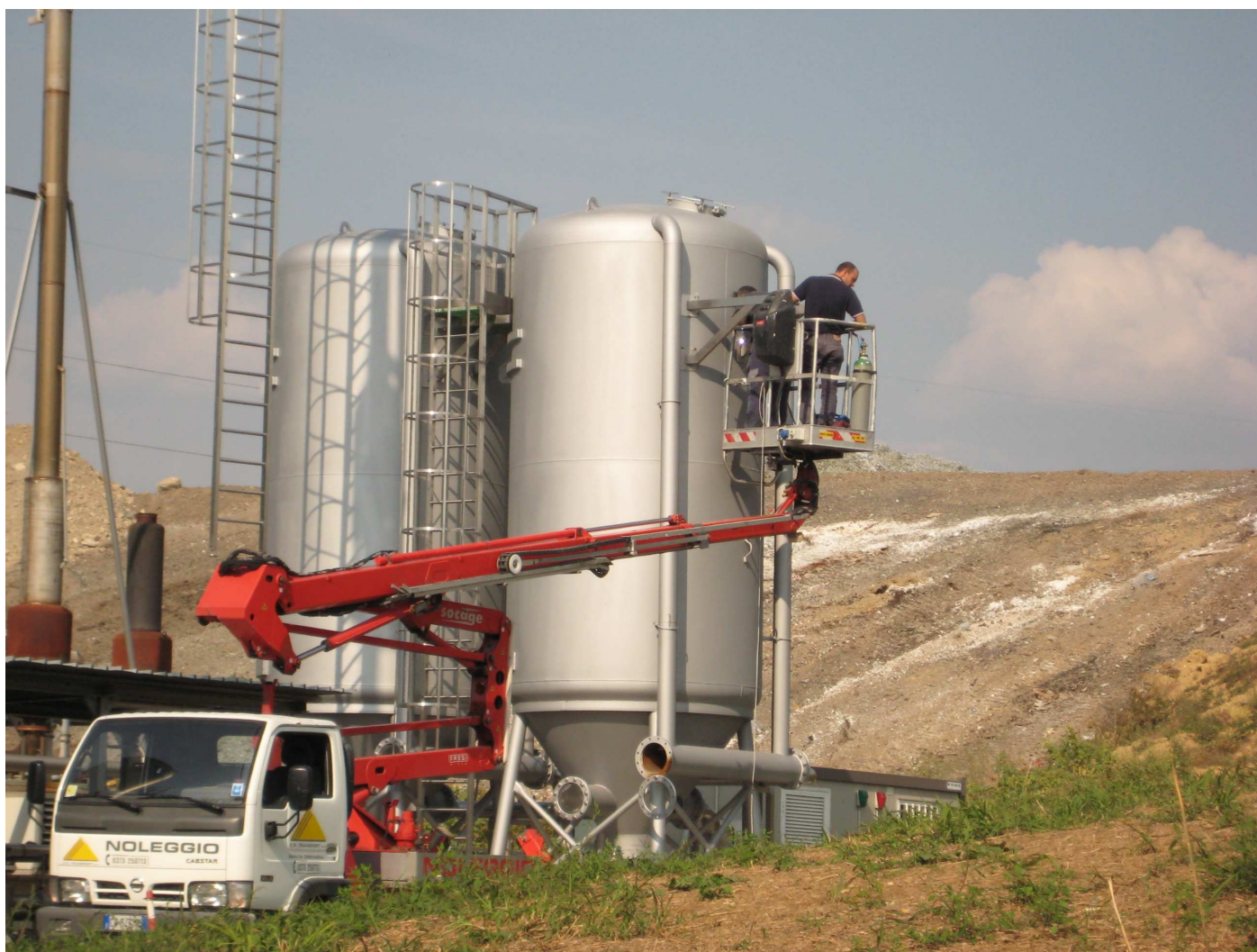
Foto 5: Nuovo impianto di adsorbimento su carbone attivo per depurare il biogas prima della sua combustione
