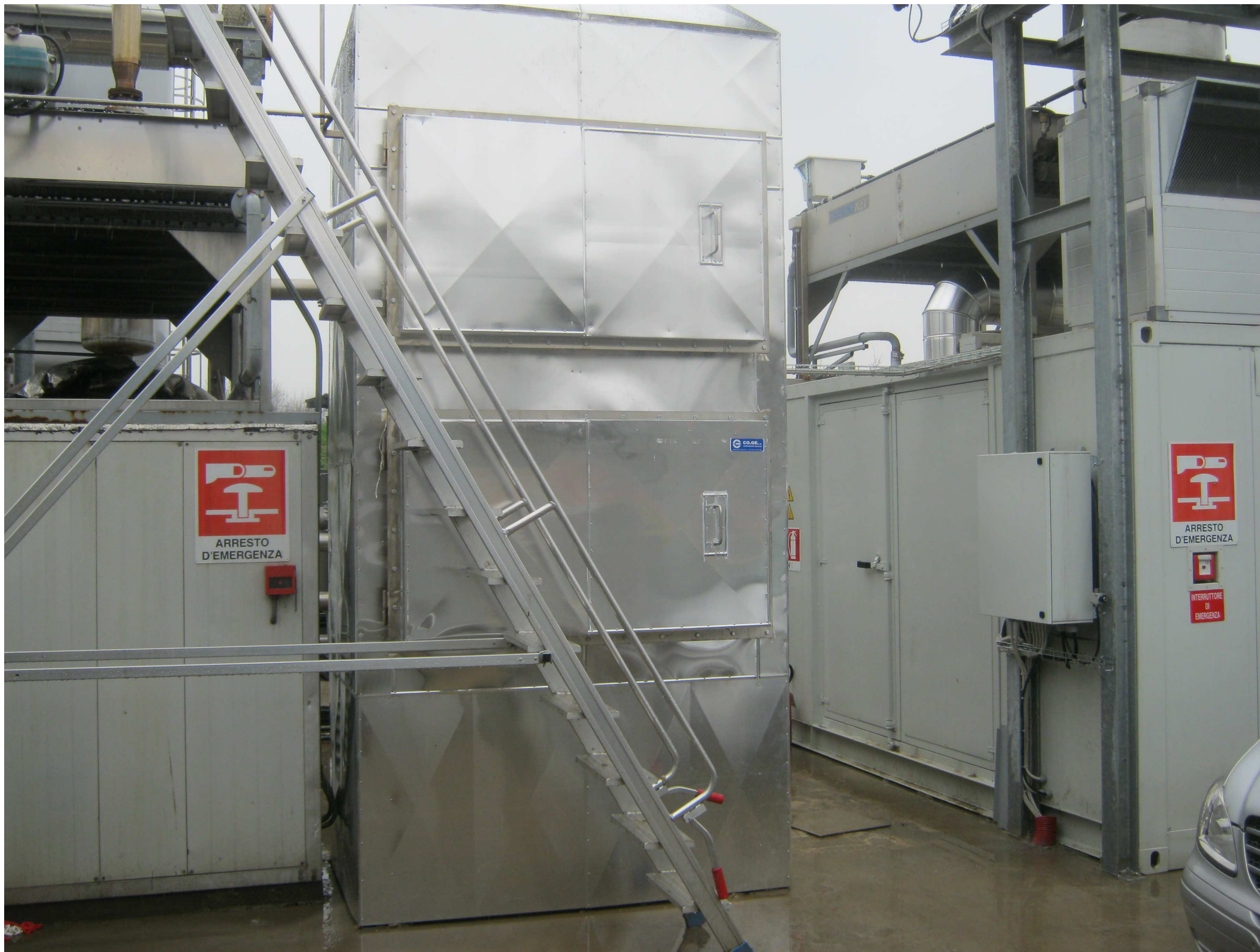
Figura 4. Vista della sezione DeNOx del nuovo impianto di generazione elettrica
