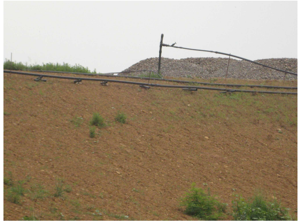
Foto 4. Completamento rete raccolta biogas
