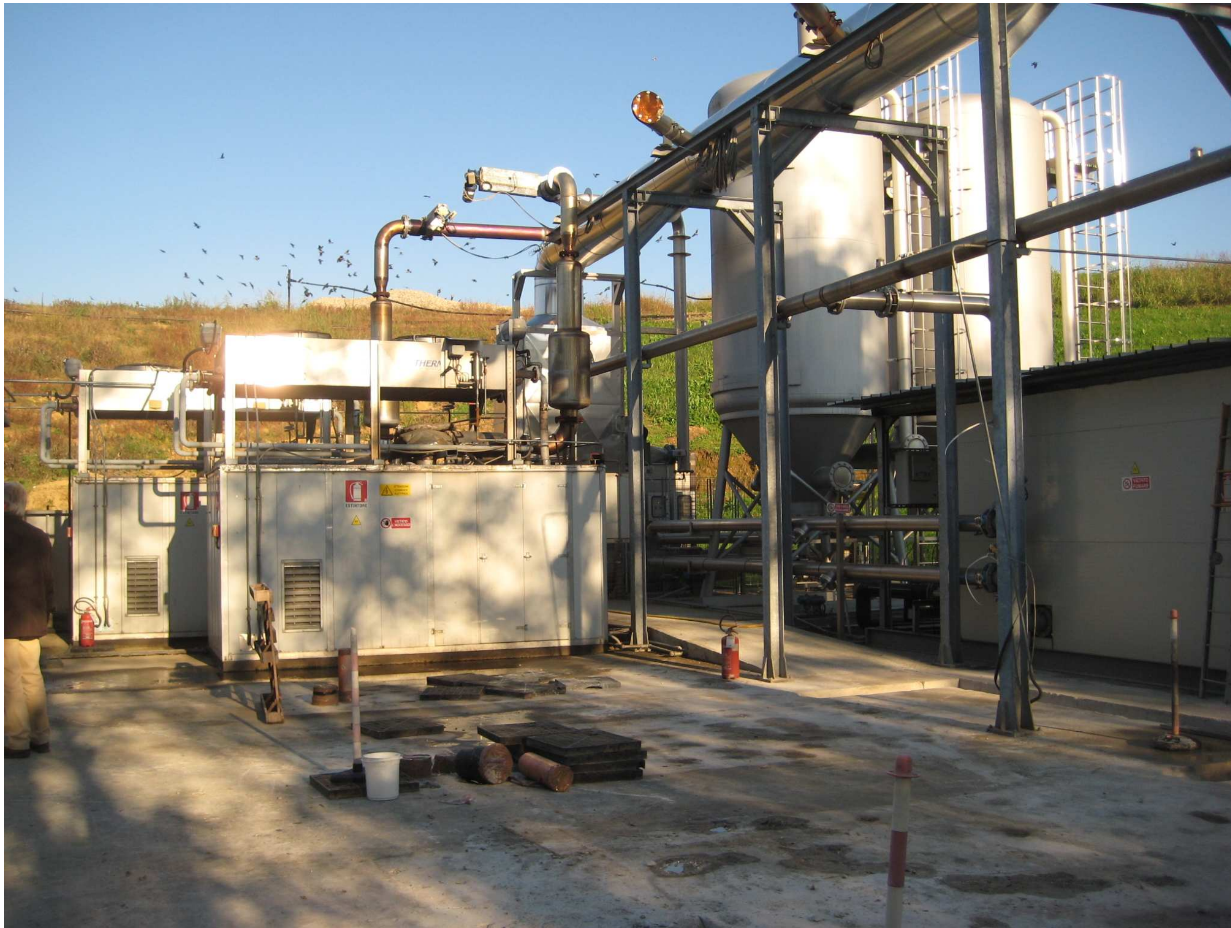
Figura 3. Vista dell'impianto di generazione elettrica da biogas
