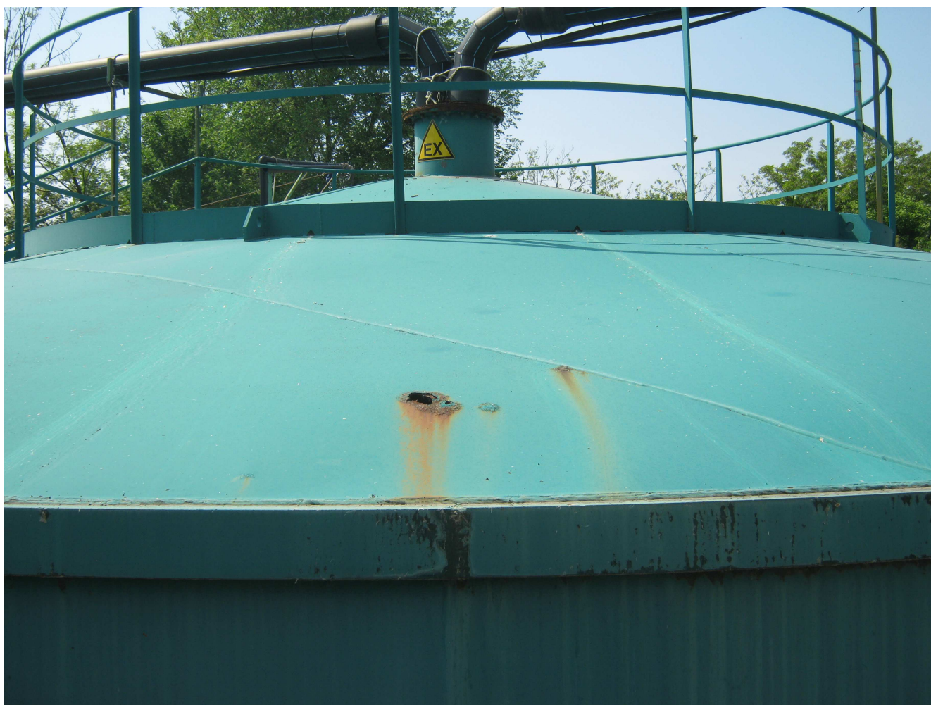
Foto 3. Foro da corrosione sul tetto del serbatoio di stoccaggio del percolato
