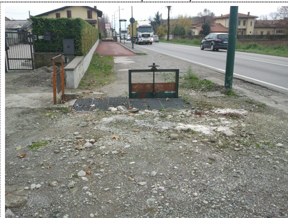
Foto 3: Paratoia della Seriola di Calcinate in prossimità dell'incrocio tra la SS498 e la SP92.
