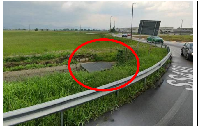
Foto 2: Griglia in corrispondenza del tratto tombinato della Roggia Seriola di Calcinate nel territorio di Calcinate.
